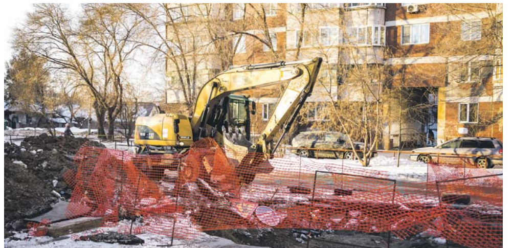
Возможная причина аварии, произошедшей 11 января на улице Пархоменко, — электрохимическая коррозия трубы 1974 года.
