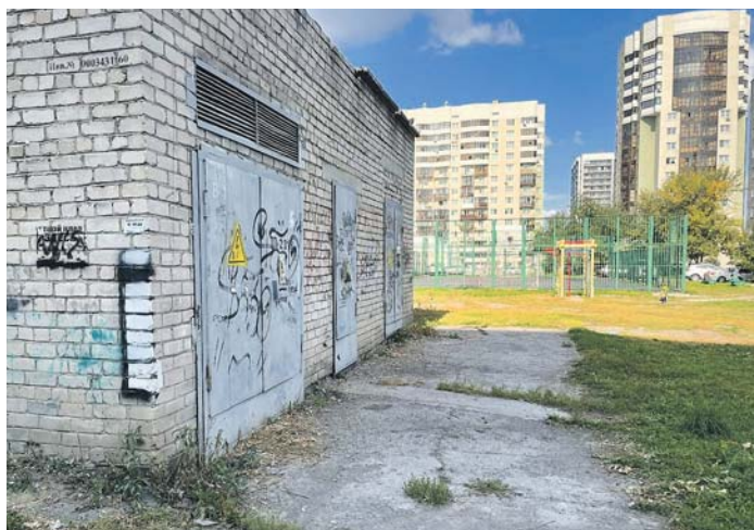
Уход необходим не только за дворами, но даже за объектами инфраструктуры. Жители домов по улице Шмидта, 6/1 и 8 с тревогой наблюдали, как клён постепенно разрушал здание подстанции. Депутат Курочкин обратился в АО «РЭС», которое провело ремонт и благоустройство строения.
