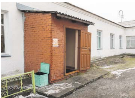
Участковая больница в Посевной ждёт капитального ремонта.
